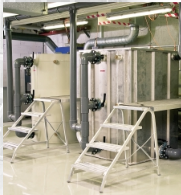
Mesure de niveau dans une installation de traitement d'eau
